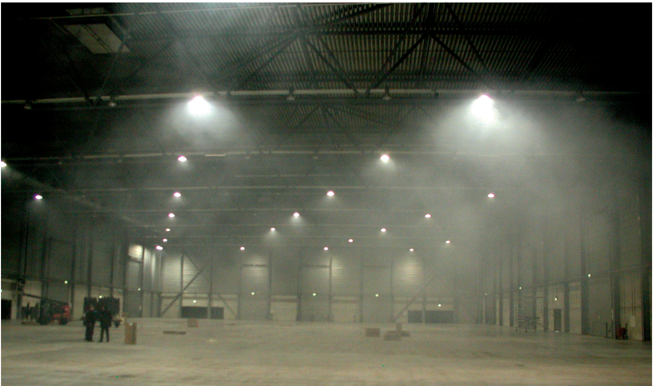
1. De Brabanthallen in Den Bosch, waarbij het luchtdistributiekanaal voorzien van plenums met inblaasnozzles aan één zijde van de hal is gesitueerd. Met rookgeneratoren is de doorspoeling getest.
